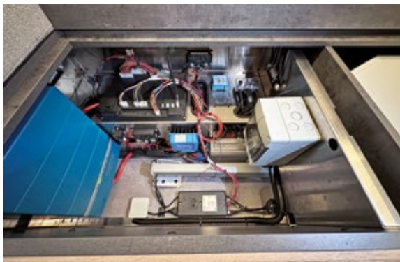
Genug Energie für Autarkie. 460 Ampere reichen für ein verschwenderisches Wochenende am Strand. Dank vollständiger Überwachung durch CZONE-Geräte hat man die Kapazitäten stets im Griff.
